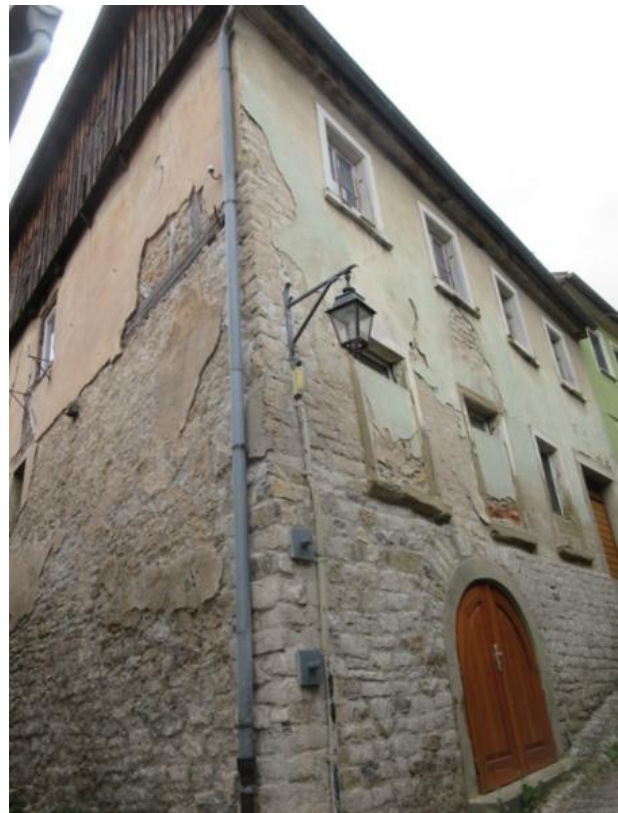
Eine Ansicht des Rückgebäudes in der Goldgasse. Man sieht, dass hier schon jahrzehntelang nichts mehr renoviert wurde.
