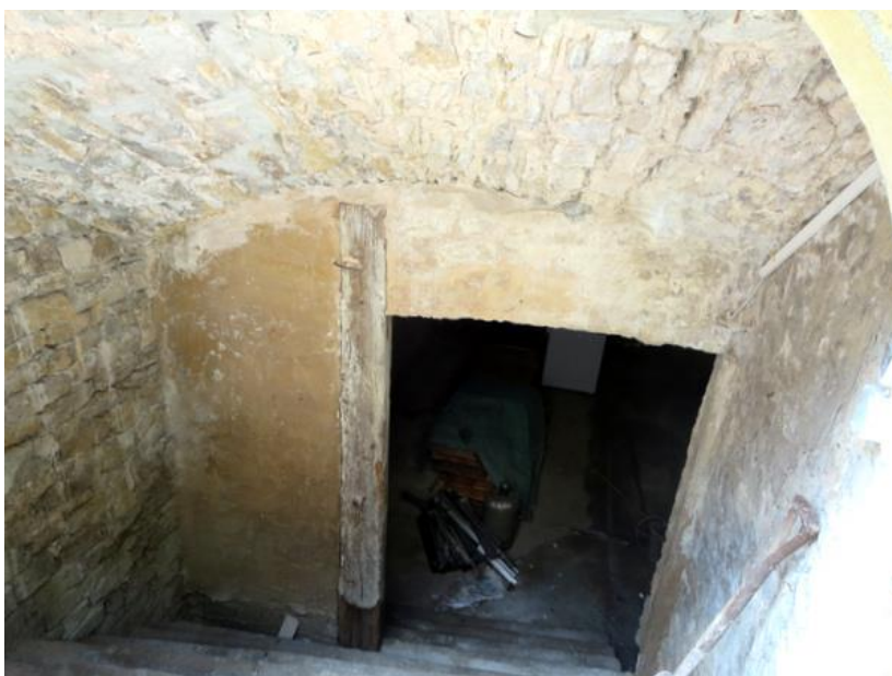
Das Gebäude besitzt einen großen Keller, der jedoch nur schwer zugänglich ist.
