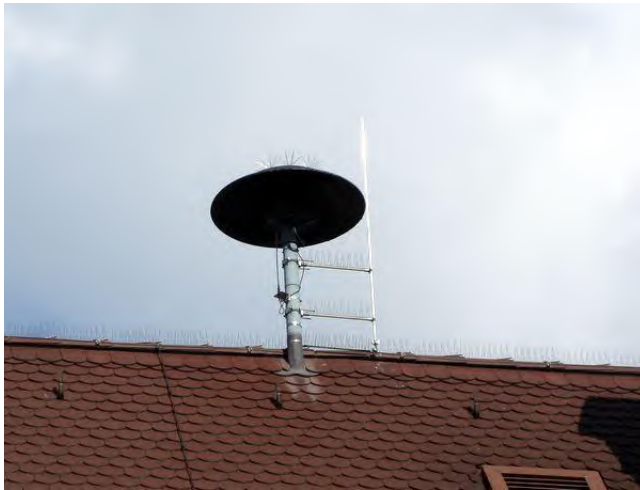
Feuersirene auf einem Dach
