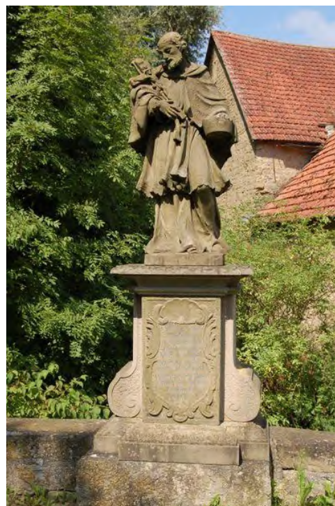
Die Sanierung der Wernbrücke in Gänheim wurde im Stadtrat heiß diskutiert
